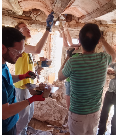
Participantes en el taller de yeso, reparando los revoltones de un forjado en la Casa-palacio de los Thomey (La Lázara)
